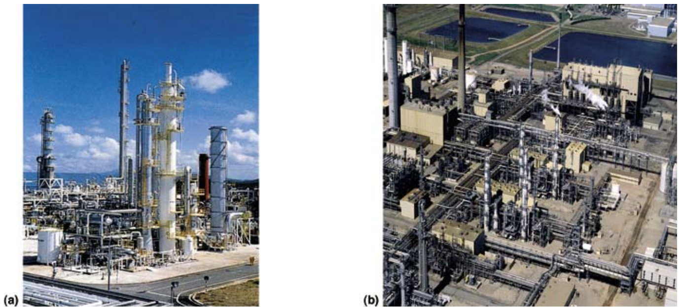
图TS.4. (a) 马来西亚某个工厂中的CO 2 燃烧后捕获，该厂采用化学吸附工艺，每年从燃气电厂的烟道气流中分离出0.2兆吨的CO 2 ，用于尿素生产（承蒙三菱重工提供）。(b) 美国北达科他州煤气化工厂中的CO 2 燃烧前捕获。该厂采用物理溶剂工艺，每年从气流中分离出3.3兆吨的CO 2 ，用于生产合成天然气。捕获的一部分CO 2 用于加拿大的EOR项目。
